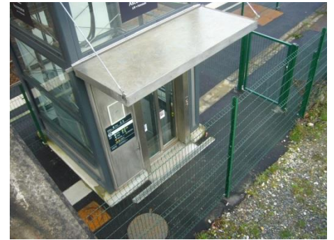
Ascenseur à la gare de Lison
