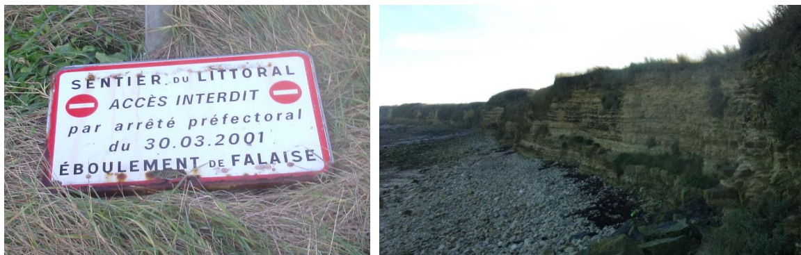
Falaise de Cricqueville en bessin : l'accès à la bordure du plateau est interdit en raison des risques d'éboulement, source : Planis
